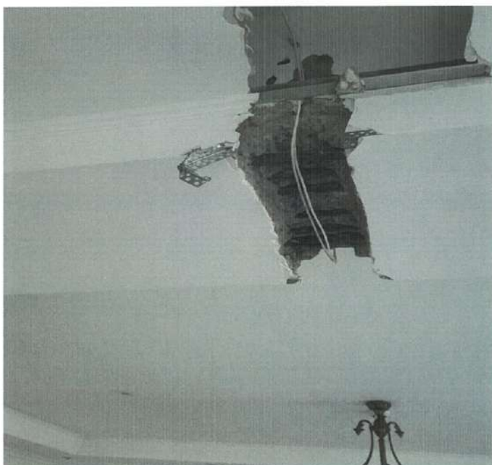
Фото 5. Гладкая арматура в растянутой зоне балки над проемом в поперечной стене 2-го этажа в осях А-Б/2
