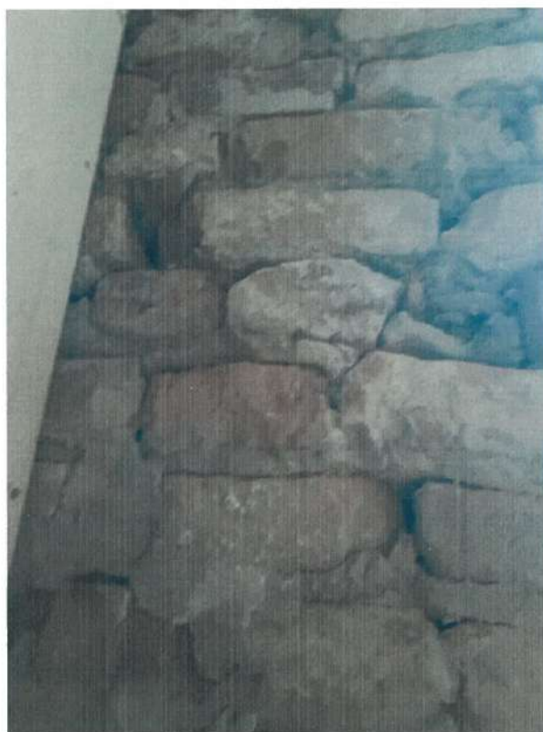
Фото 4. Кирпичная несущая стена по оси А на 3-м этаже здания выполнена низкого качества: отсутствует перевязка в кладке, раствор выбирается руками, вертикальные швы не заполнены раствором
